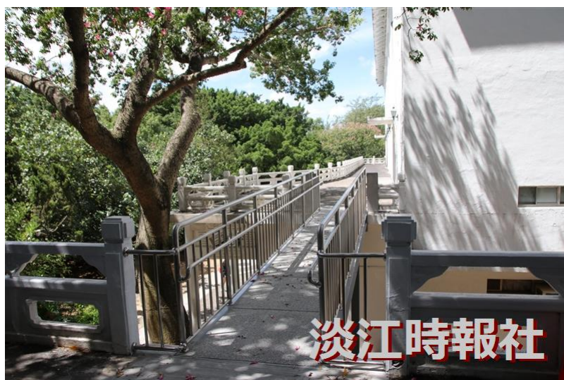
總務處於暑假期間進行校園設施整建與強化，於活動中心後方增建永久性無障礙通道。（攝影／潘劭愷）
